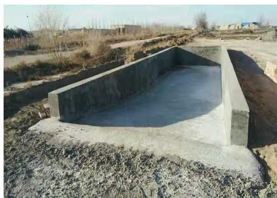
洗车平台及沉淀池
